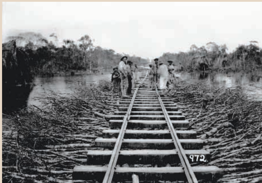
Assentamento de trilhos sobre estiva de galharia para passagem do trem de lastro, em trecho pantanoso do rio Abunã.
