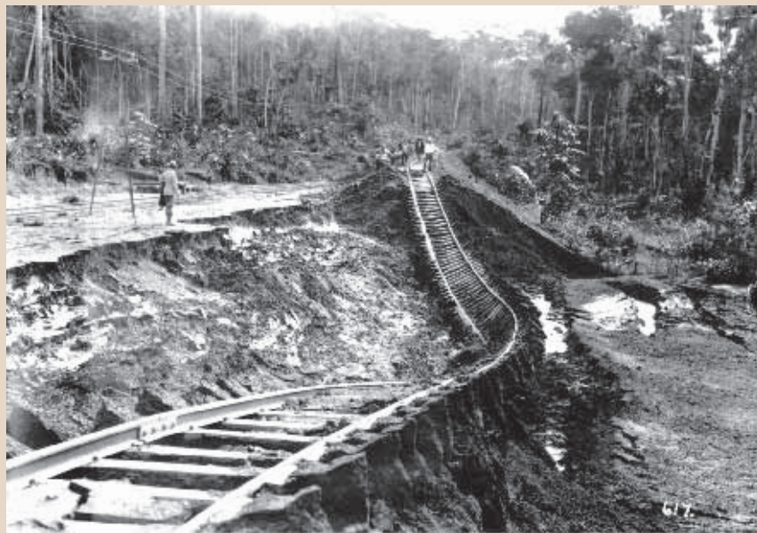
Desmoronamento de trecho construído da ferrovia, em consequência de enxurradas. O terreno em geral já não era favorável à construção de estradas. As chuvas torrenciais encarregavam-se de arrastar grandes aterros 46 . Do acervo do MP/USP.
