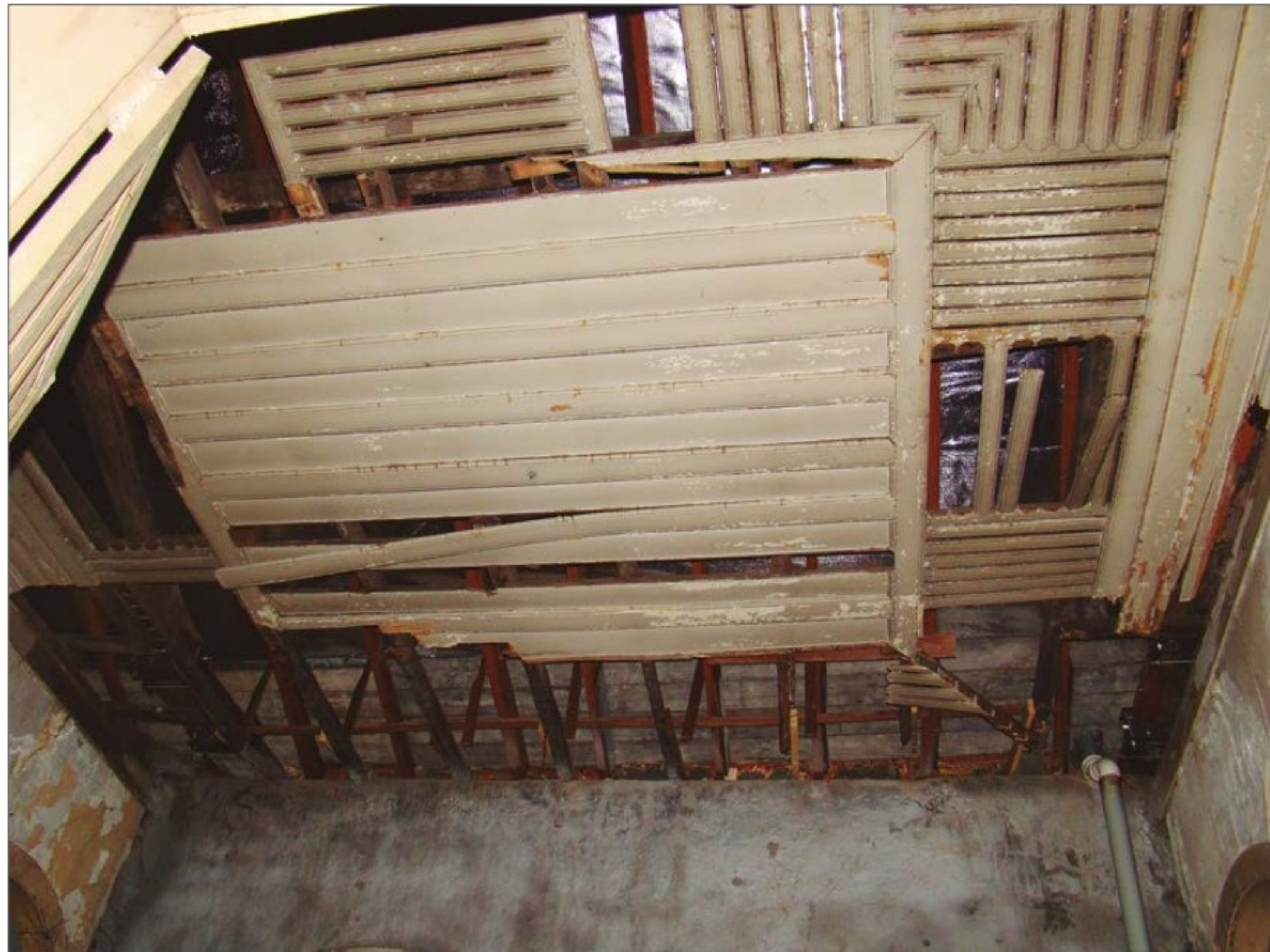
Forro de um dos quartos, com frestas entre as peças de madeira para auxiliar na ventilação do ambiente, 2012. (AS)
