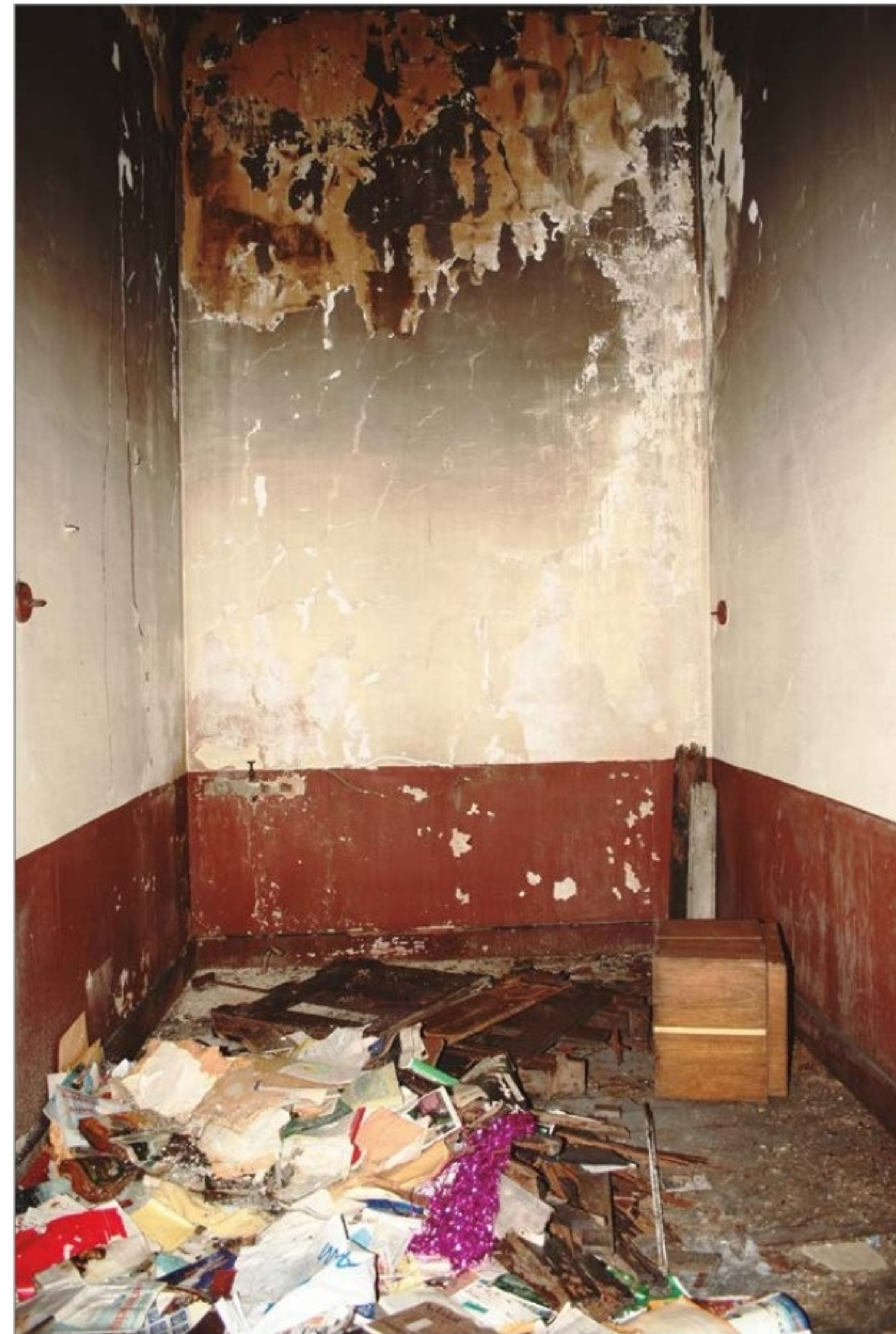
Registro de entulho de materiais e de rastros de fogo, no piso e no teto, encontrados no imóvel em 2008. (AS)
