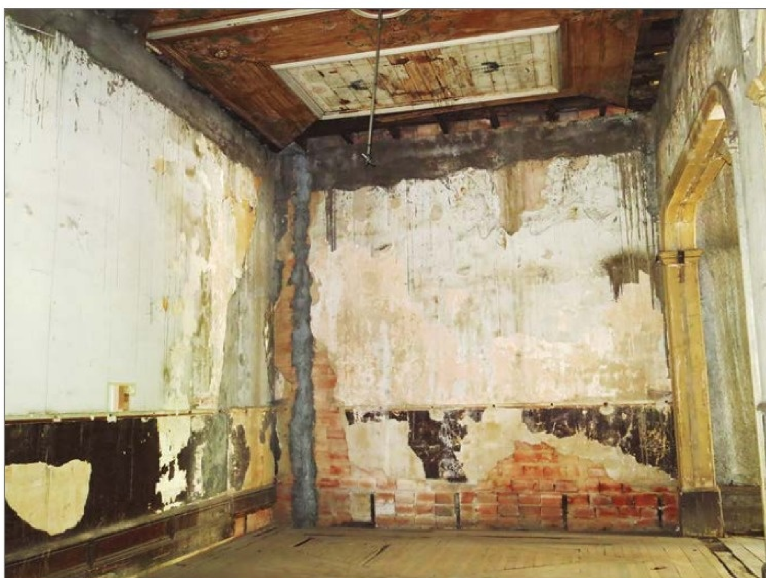
Estado crítico de conservação do piso, das paredes e do forro do Salão Principal em 2016. (KM)
