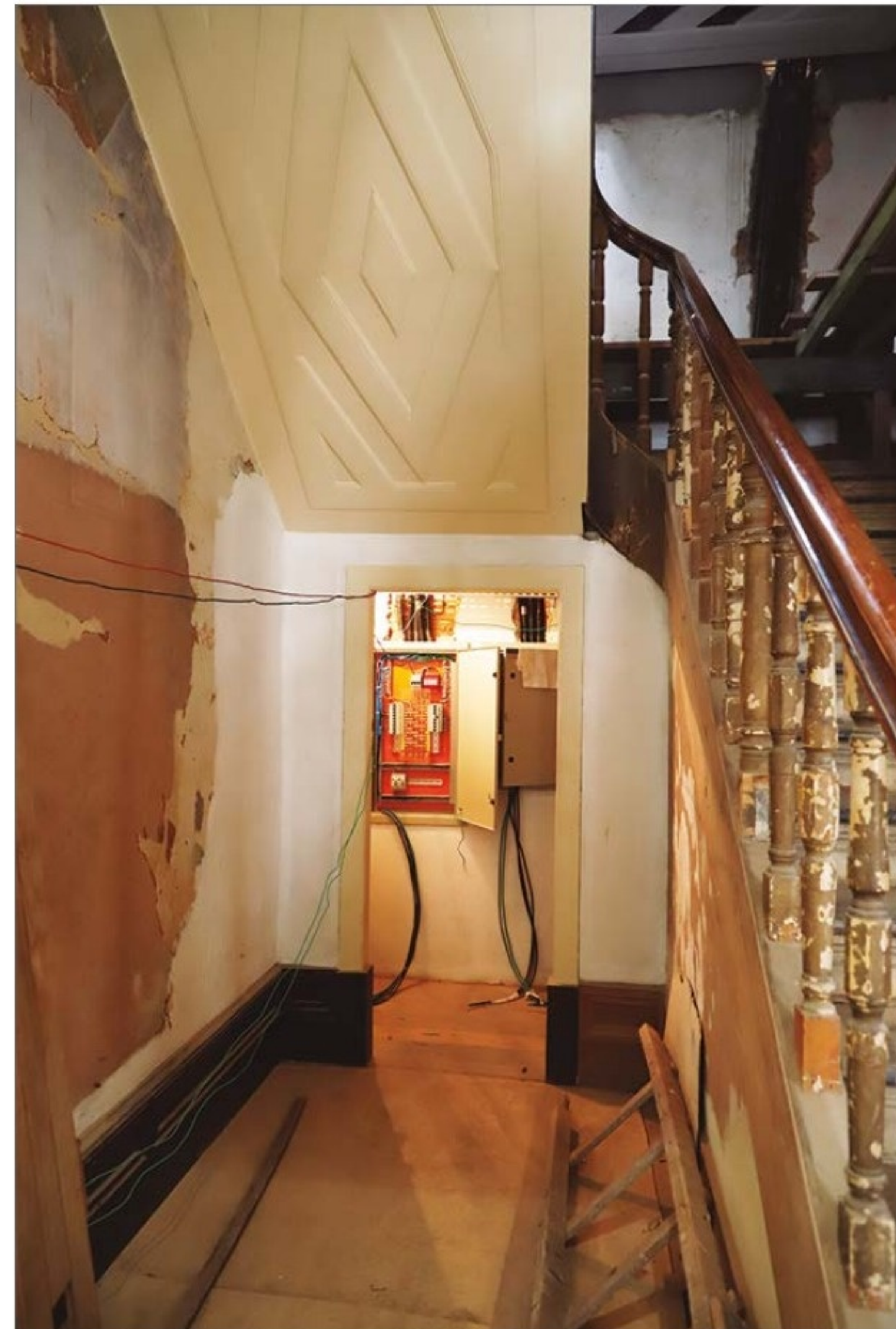
Depósito existente embaixo da escada, que passou a armazenar os quadros de energia do Palacete. (OC)
