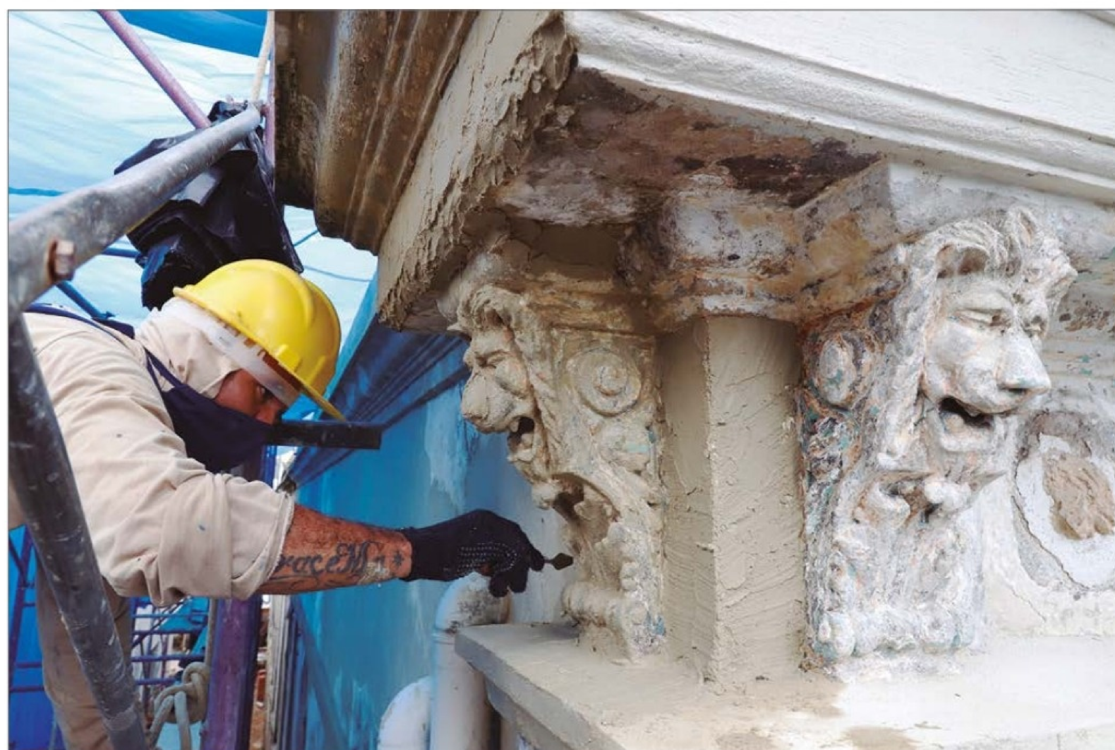
Restauração dos leões que fazem parte da ornamentação da fachada da Casa 03. (OC)
