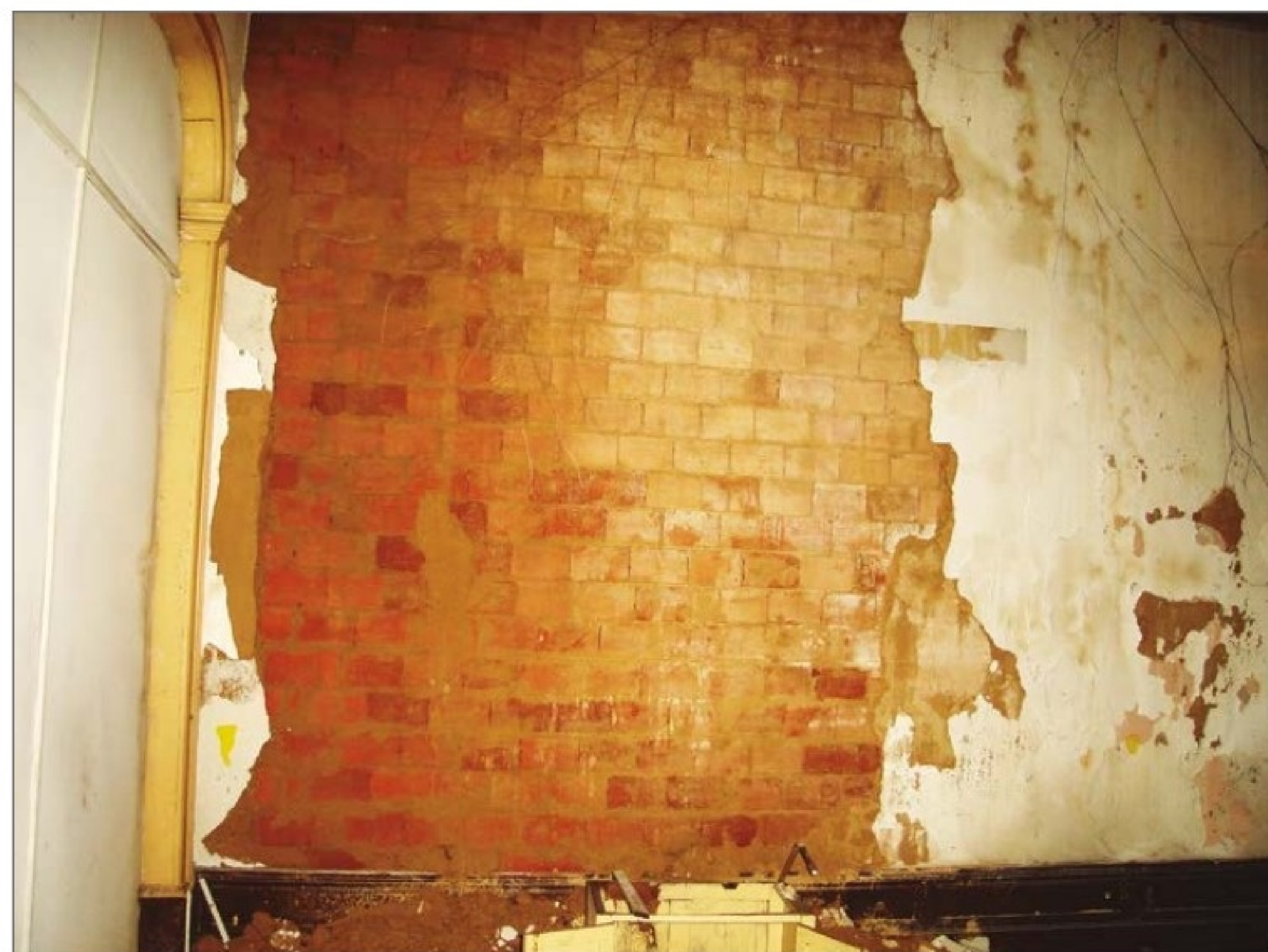
Na Sala de Música, grande parte da argamassa original foi perdida, 2007. (AS)
