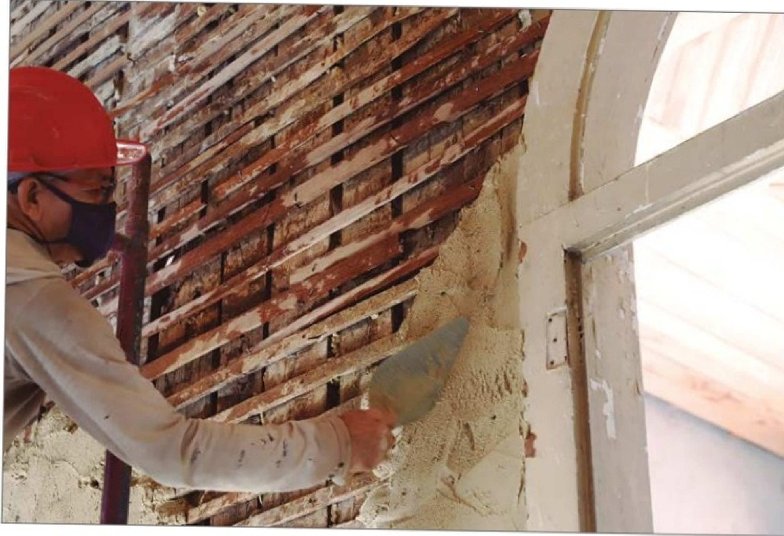
Paredes de tabique recompostas a fim de preservar a técnica construtiva. (OC)
