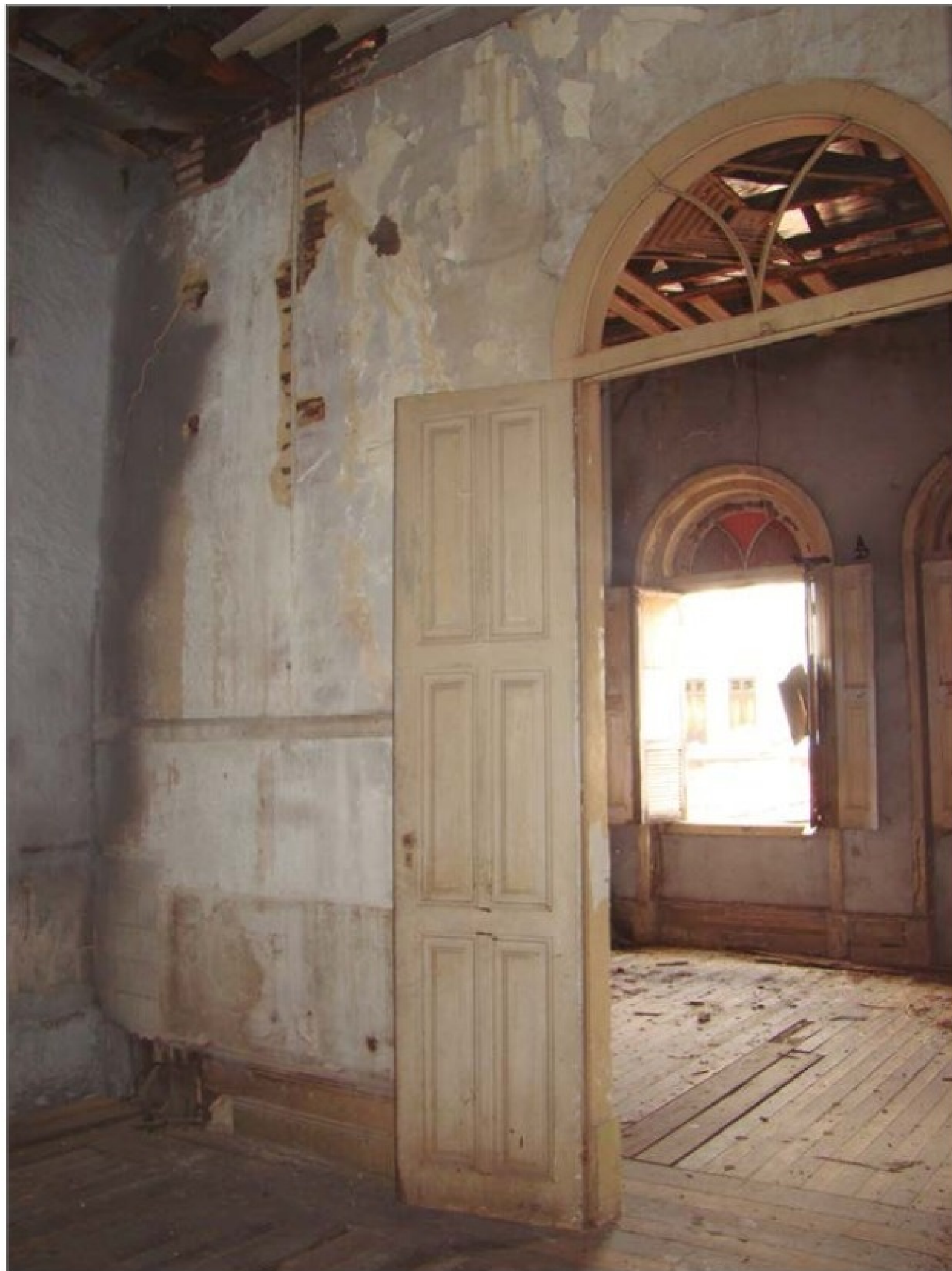
As paredes internas do pavimento superior do Palacete apresentavam danos em sua estrutura. Em 2008, observava-se a falta de partes de reboco e de peças de madeira. (AS)
