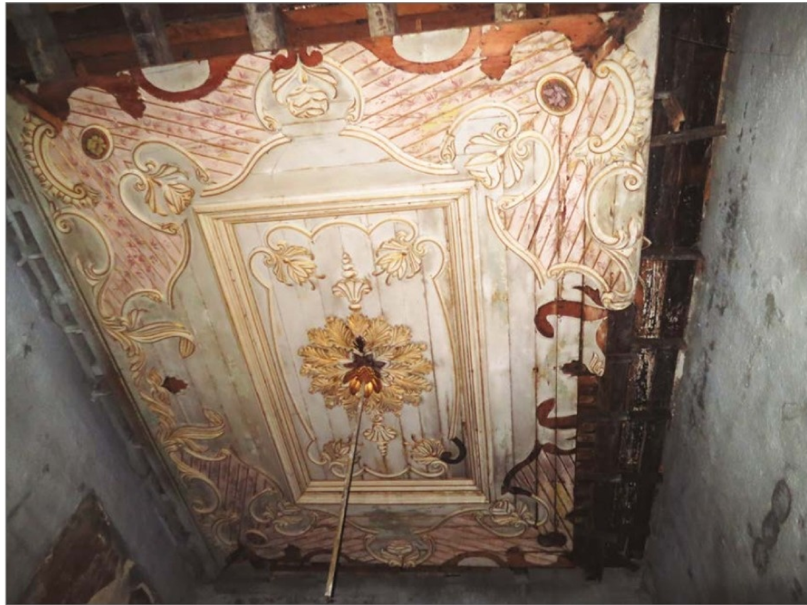
Forro da Sala Nobre, bastante danificado em 2016. (KM)
