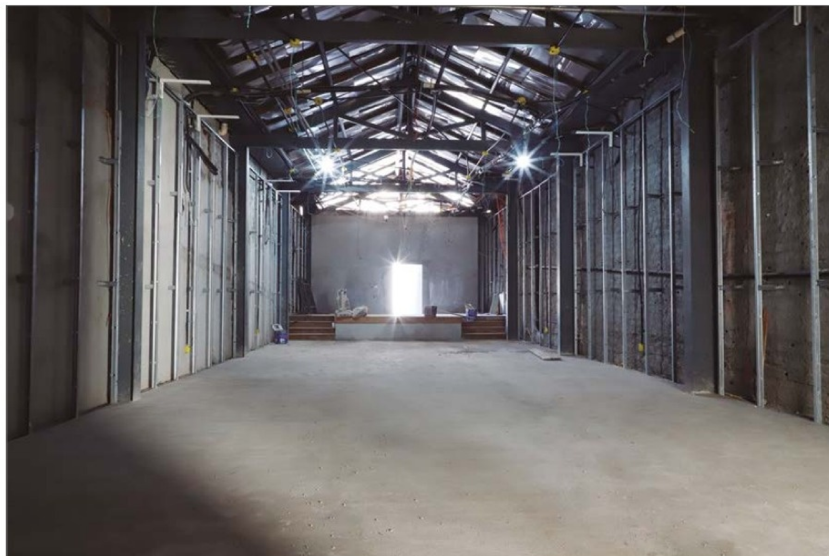
Sistema de cobertura da Casa 02 com estrutura metálica, e permanência da laje de concreto pré-existente. (OC)
