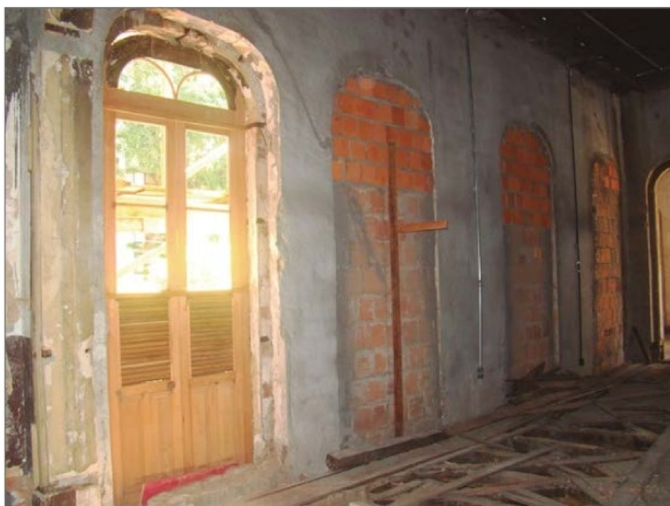
Acesso à varanda lateral, em ambiente com piso, parede e forro bastante danificados, 2016. (KM)
