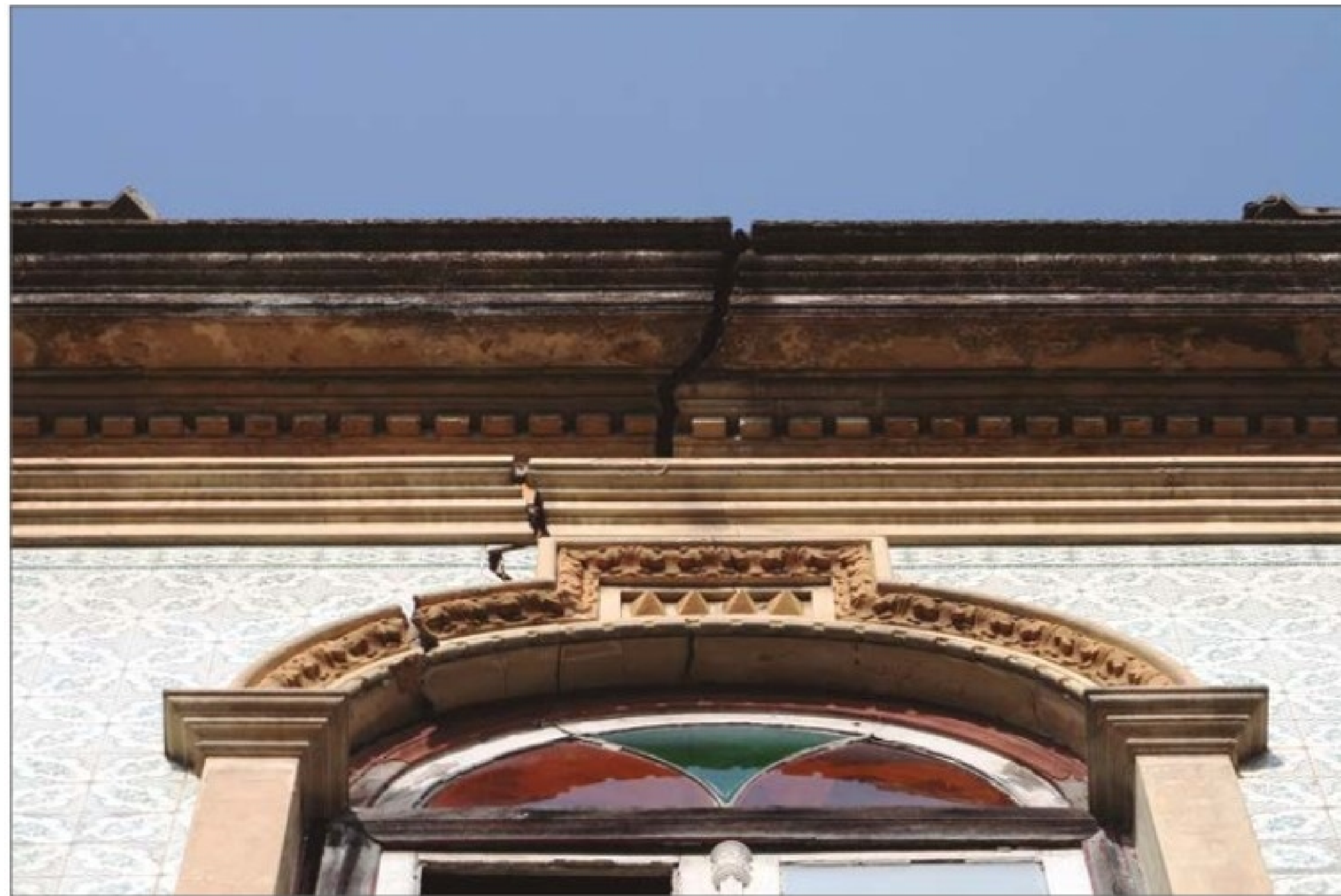
Registro da trinca na fachada lateral do Palacete (pela travessa Doutor Moraes), 2008. (AS)
