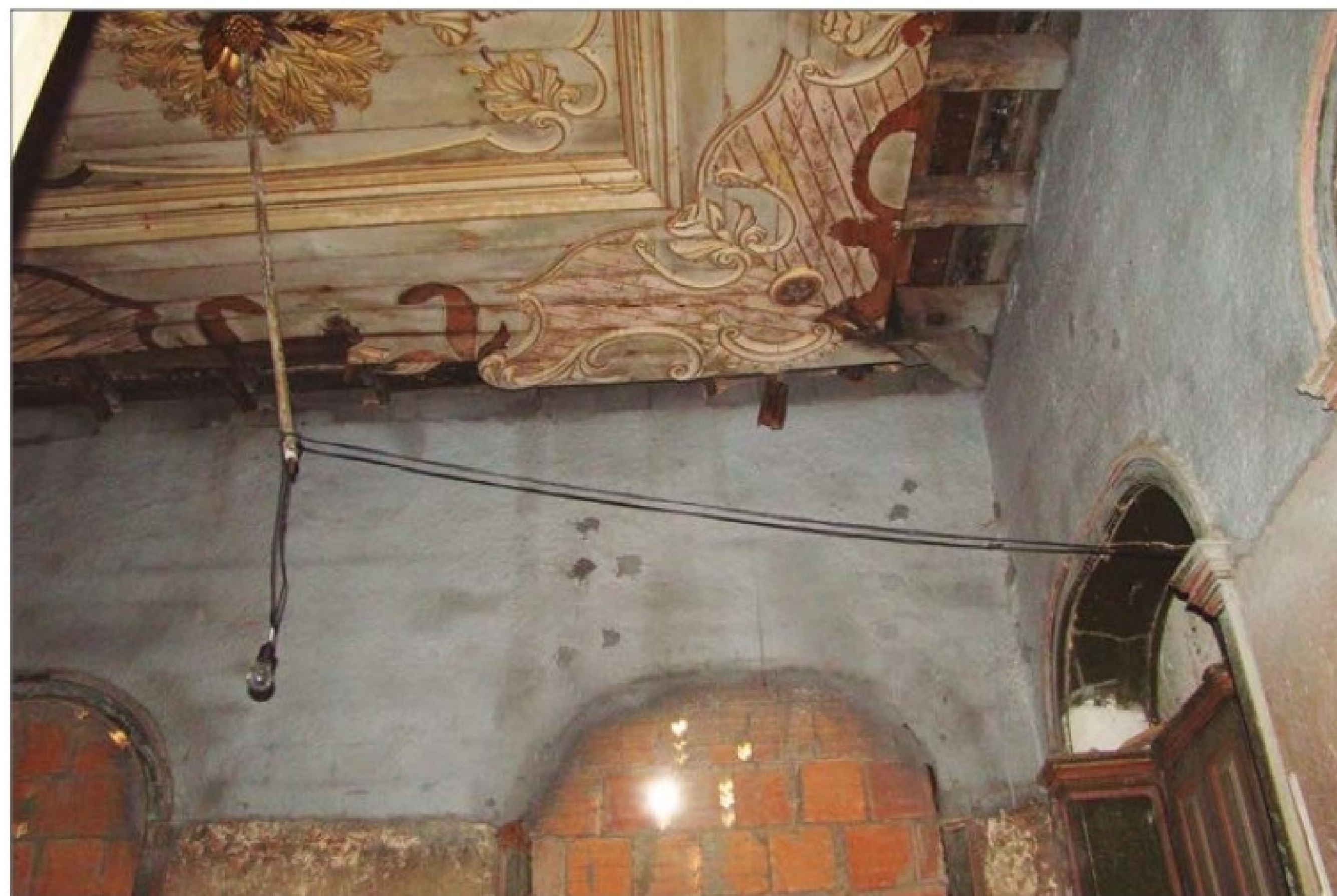
Paredes da Sala Nobre danificadas pelo jateamento em cimento, realizado na obra de reforço estrutural do imóvel. (AS)
