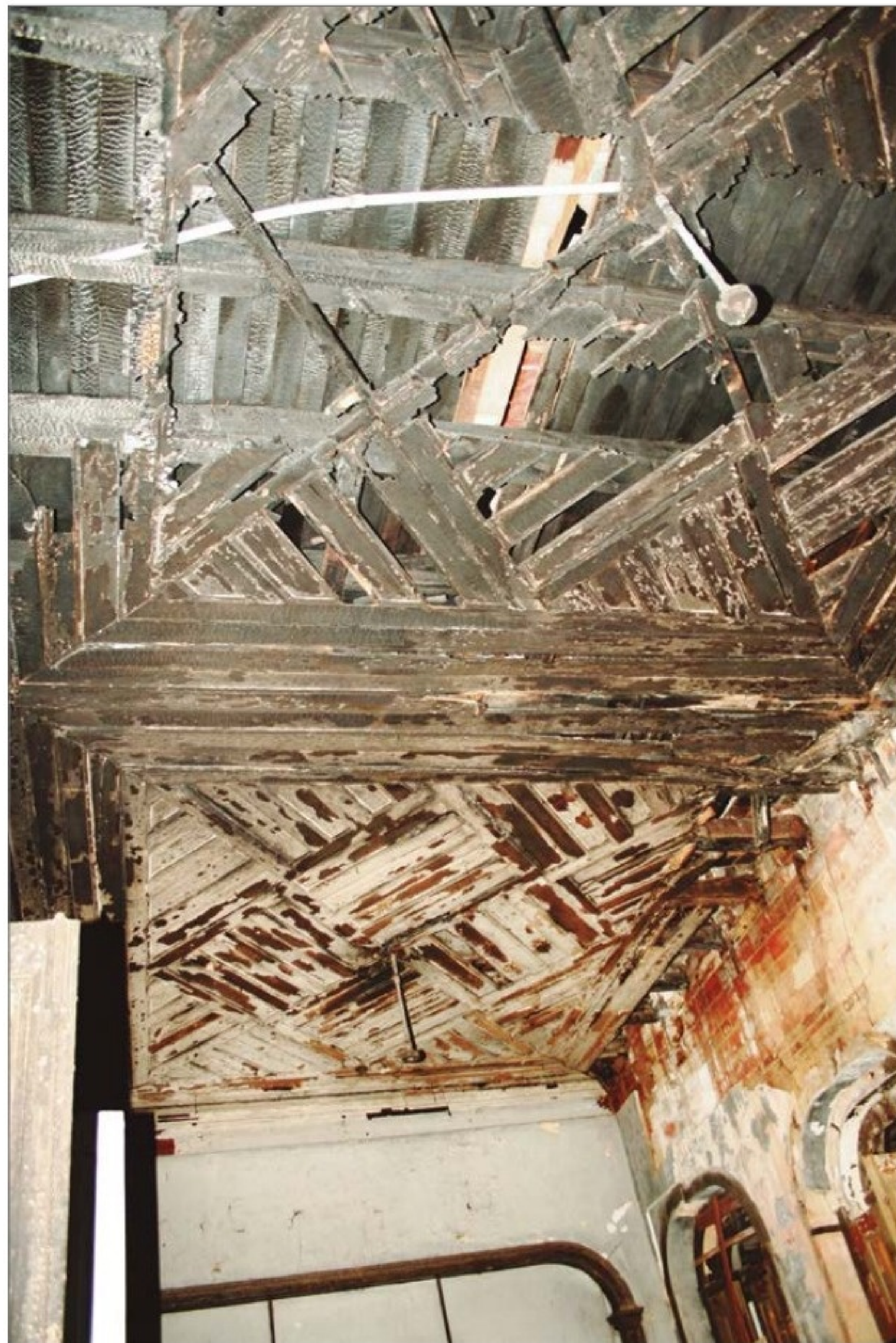
Peças de madeira do forro do térreo e do piso do pavimento superior carbonizadas devido ao incêndio ocorrido em partes da edificação antes de sua desapropriação, 2008. (AS)
