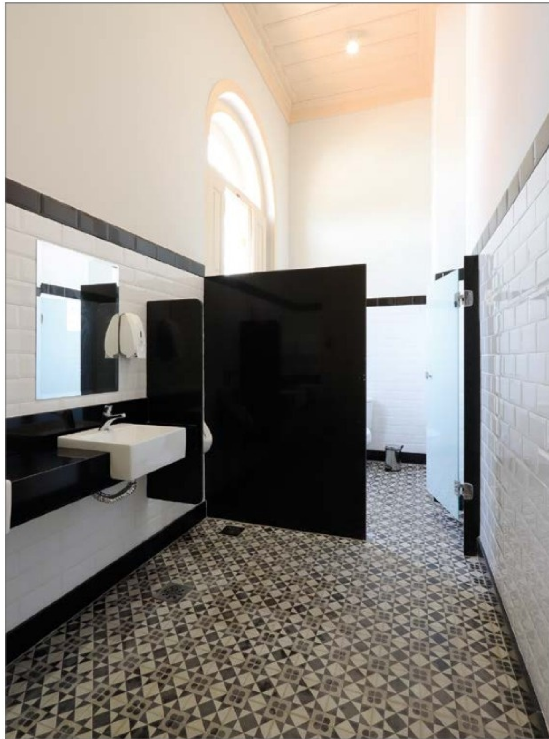
Banheiro do pavimento superior, alterado para atender à nova função que o andar possui. (OC)
