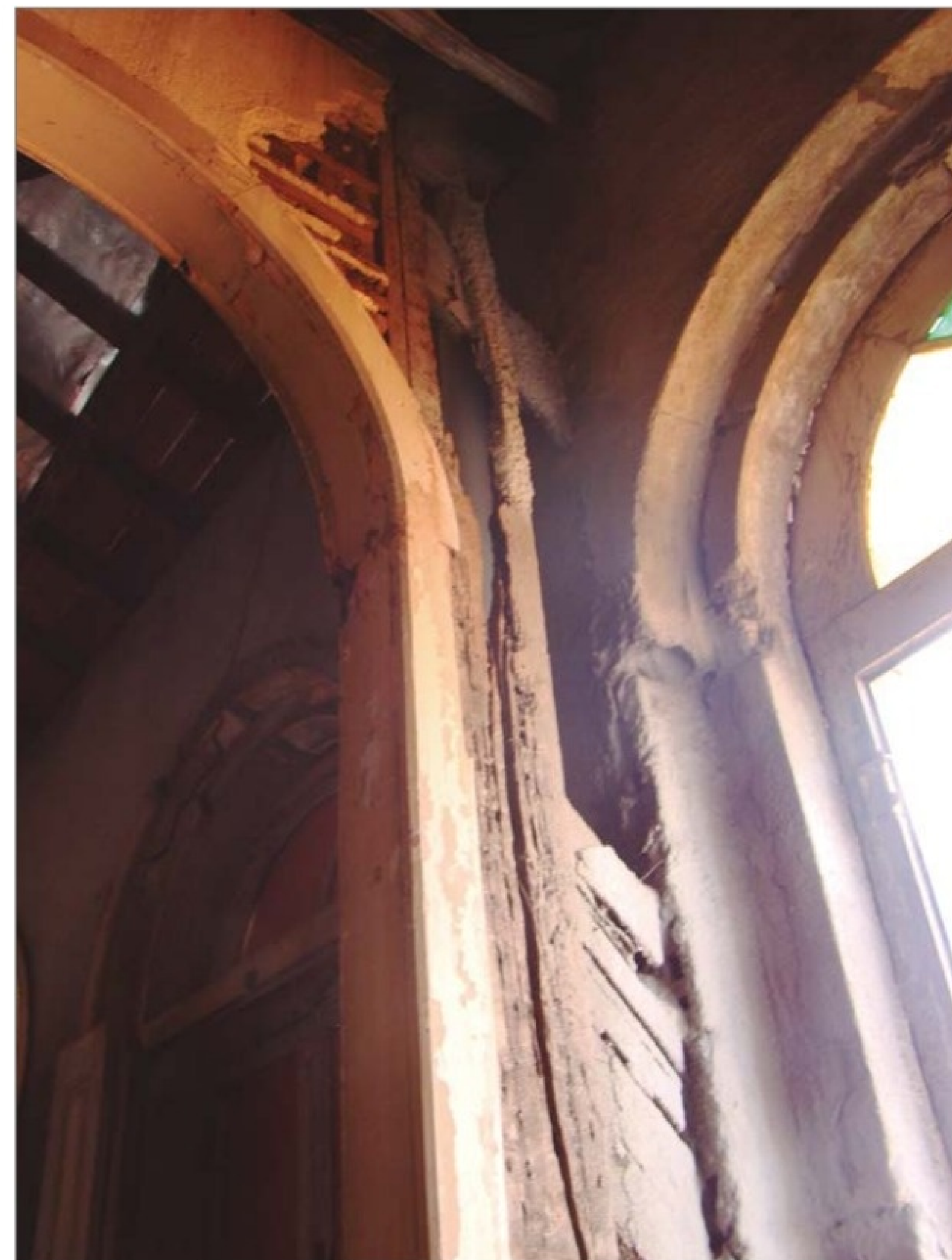
Detalhe do dano da parede de tabique interna, perpendicular à fachada principal do prédio, 2012. (AS)
