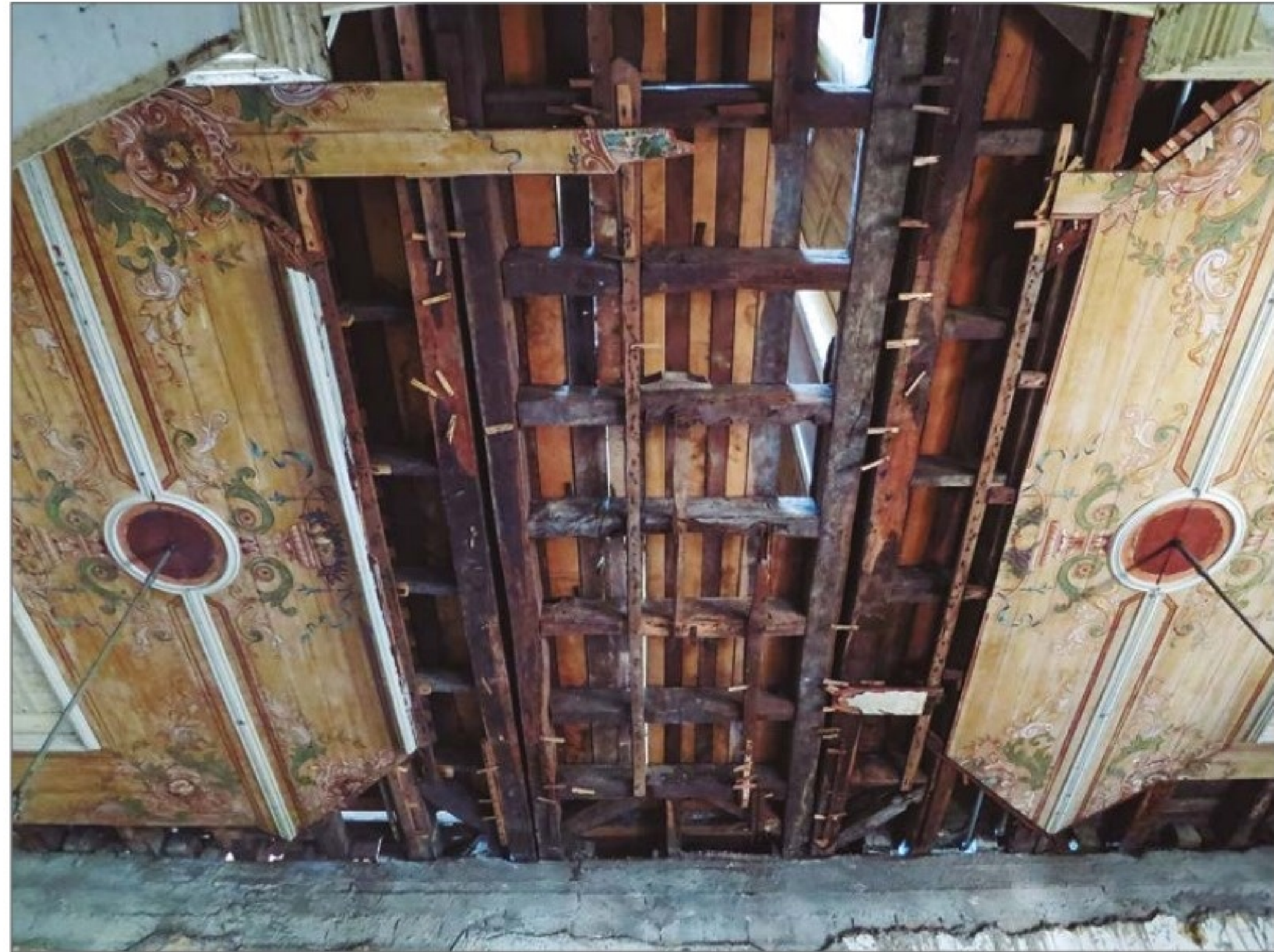
Estado precário do forro artístico do Salão Principal em 2016. (KM)
