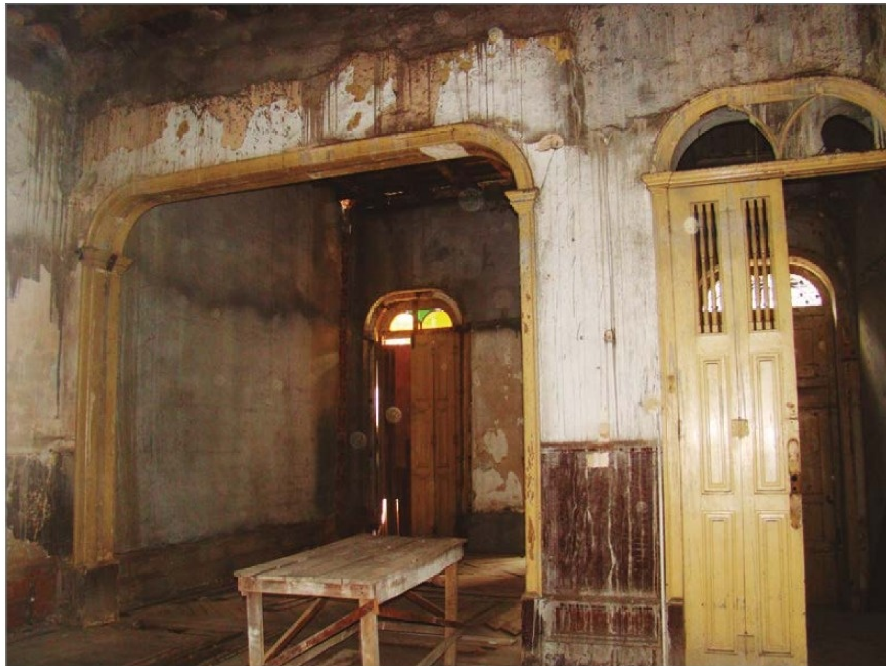
Sala de Música, em 2008; as paredes com nova argamassa e o vidro colorido ainda presente na bandeira da janela. (AS)
