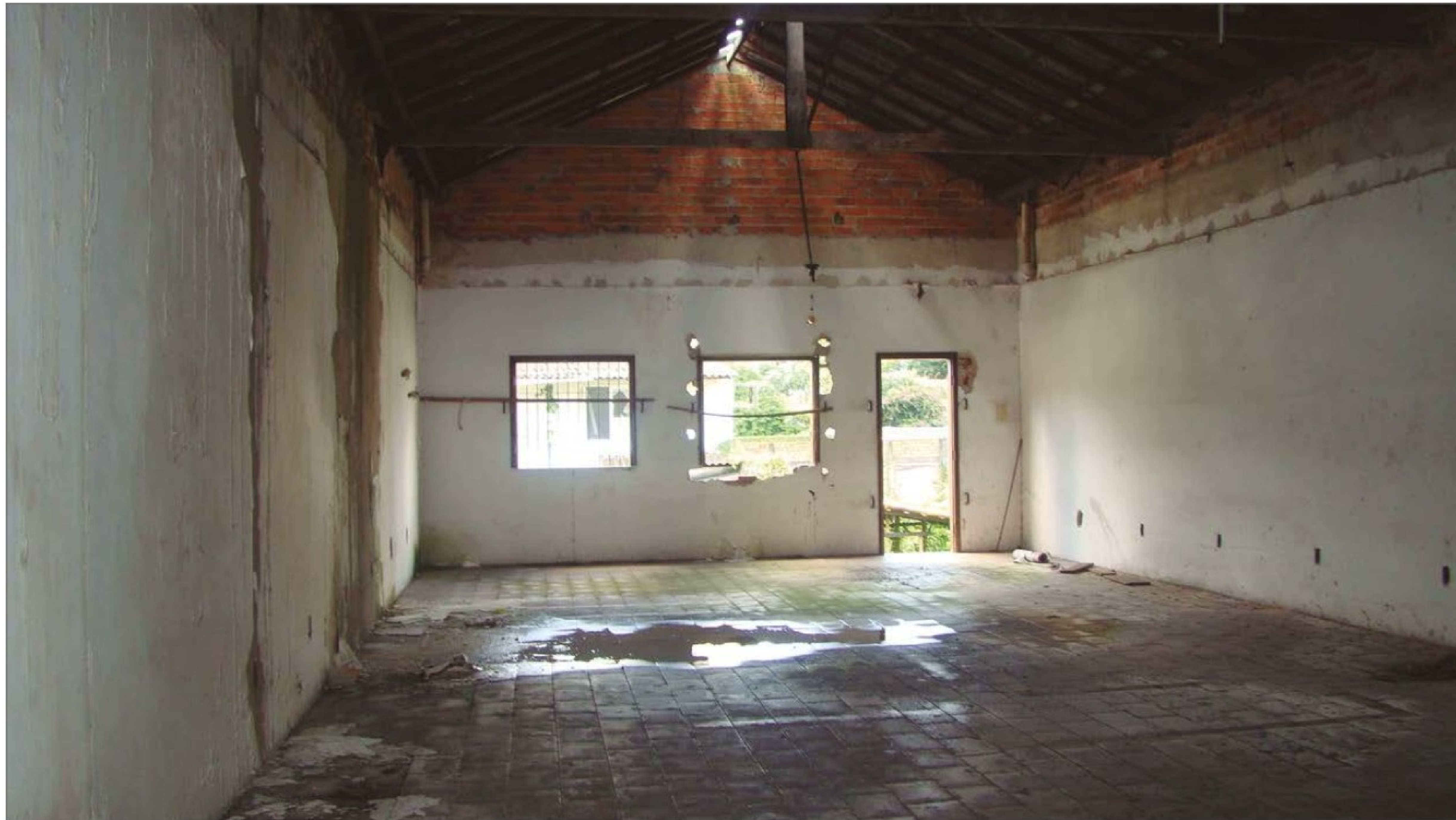
Casa 02, vista internamente do pavimento superior, em 2012, com a laje de concreto construída antes das obras do Governo do Estado. (KM)
