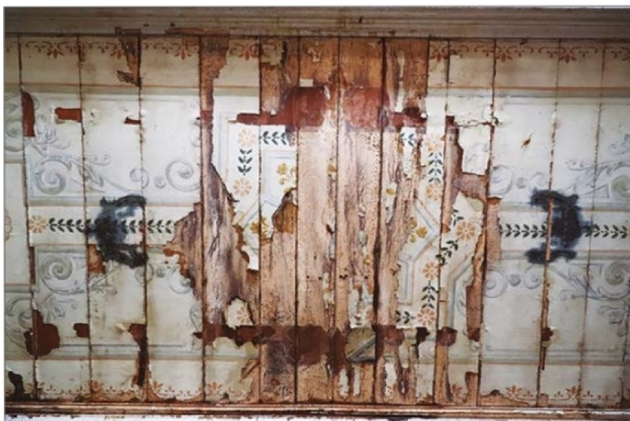
Pintura original do forro do Salão Principal, que se manteve, embora em péssimo estado de conservação. (OC)
