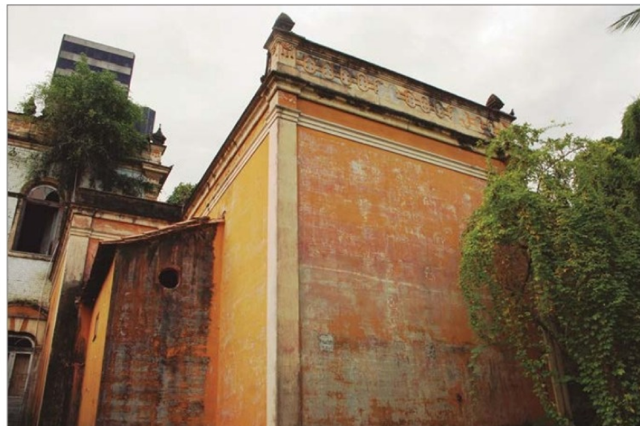
Presença de construção extemporânea (banheiro) no anexo e de vegetação aérea na fachada posterior do Palacete Faciola, 2008. (AS)
