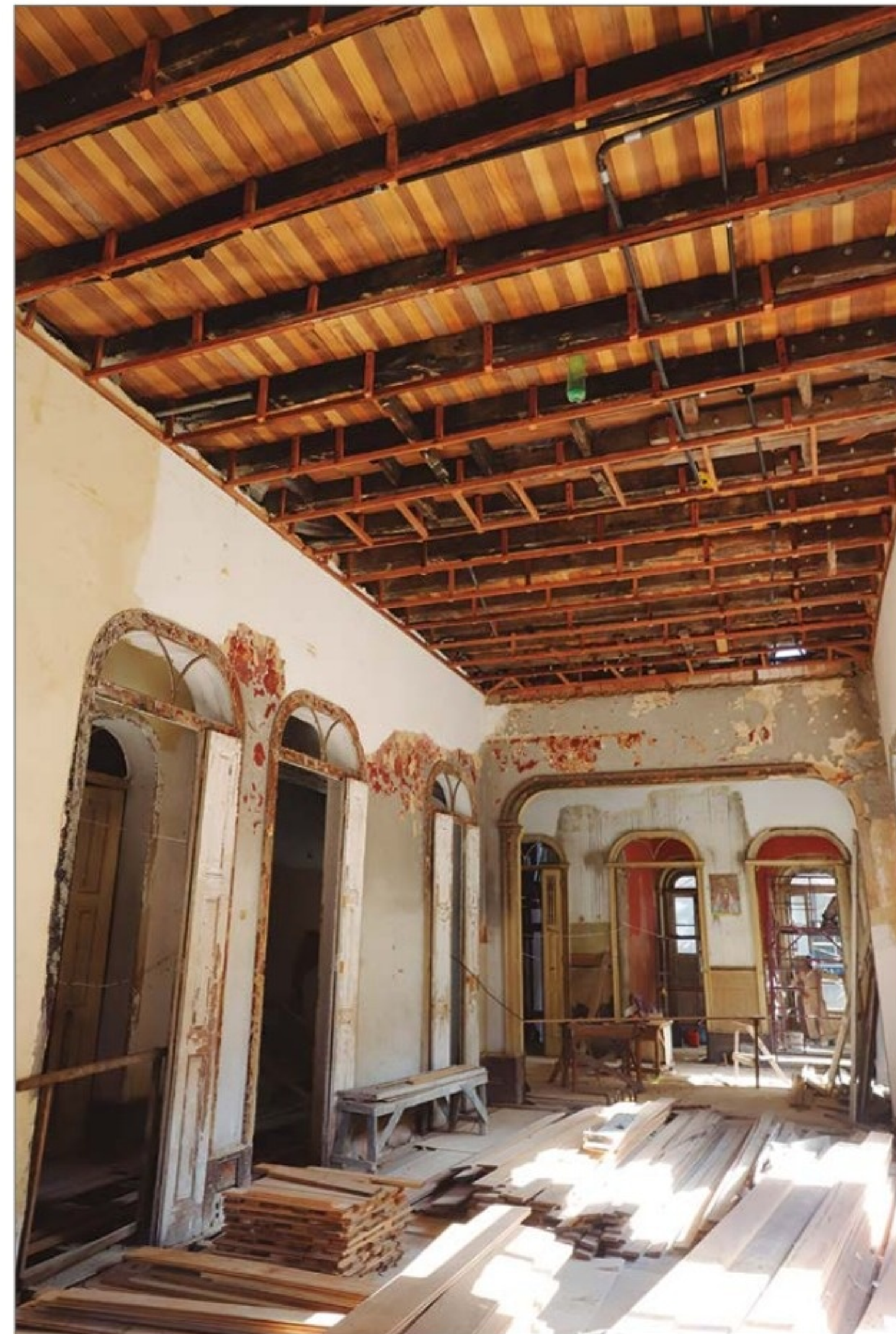
Instalação do sistema elétrico durante a recuperação dos pisos e dos forros para atender à nova função da edificação. (OC)
