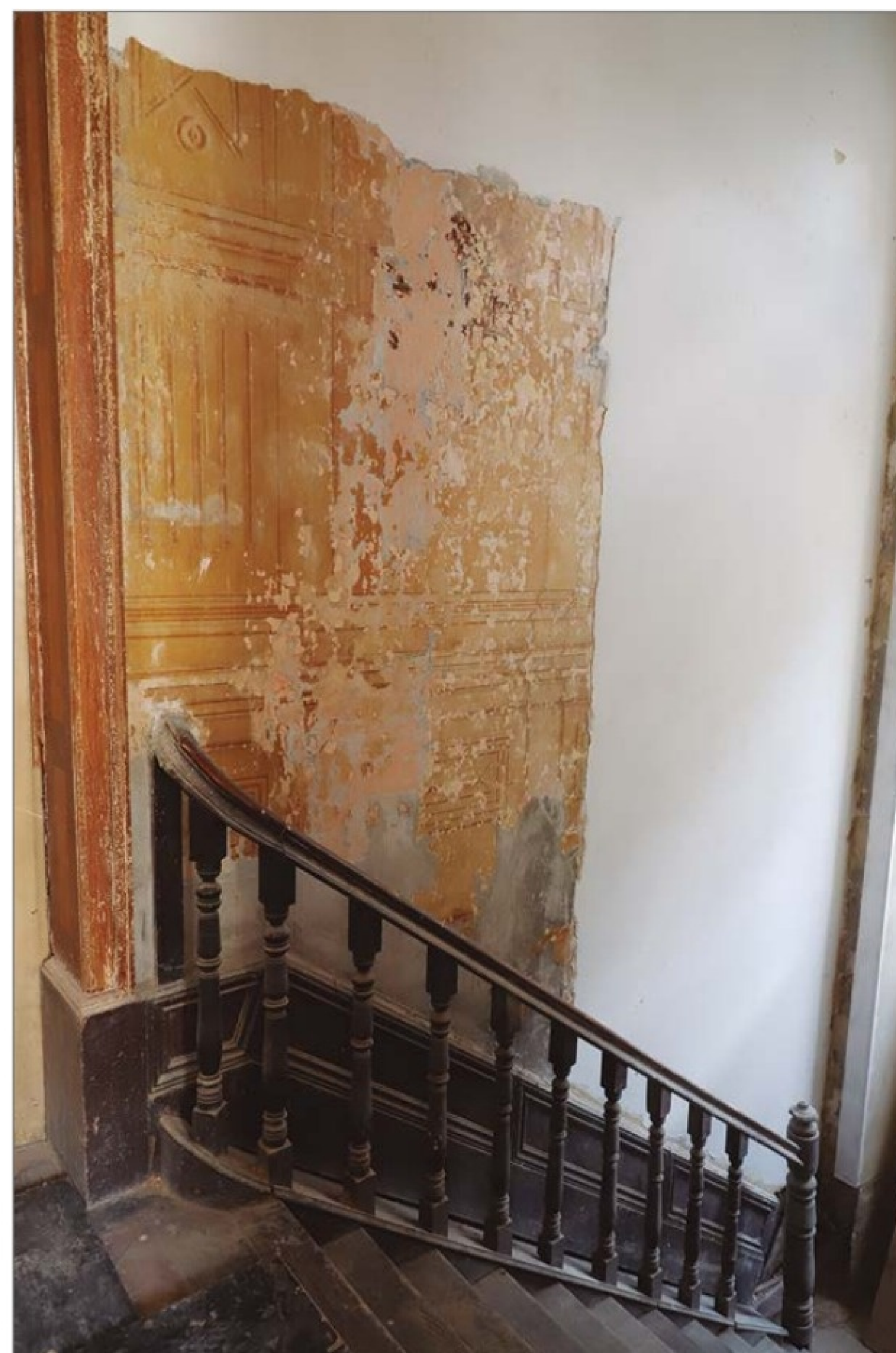
Pinturas artísticas descobertas debaixo de camadas de tinta no hall de entrada, mesmo após a perda da argamassa original em grande parte das paredes do ambiente. (OC)
