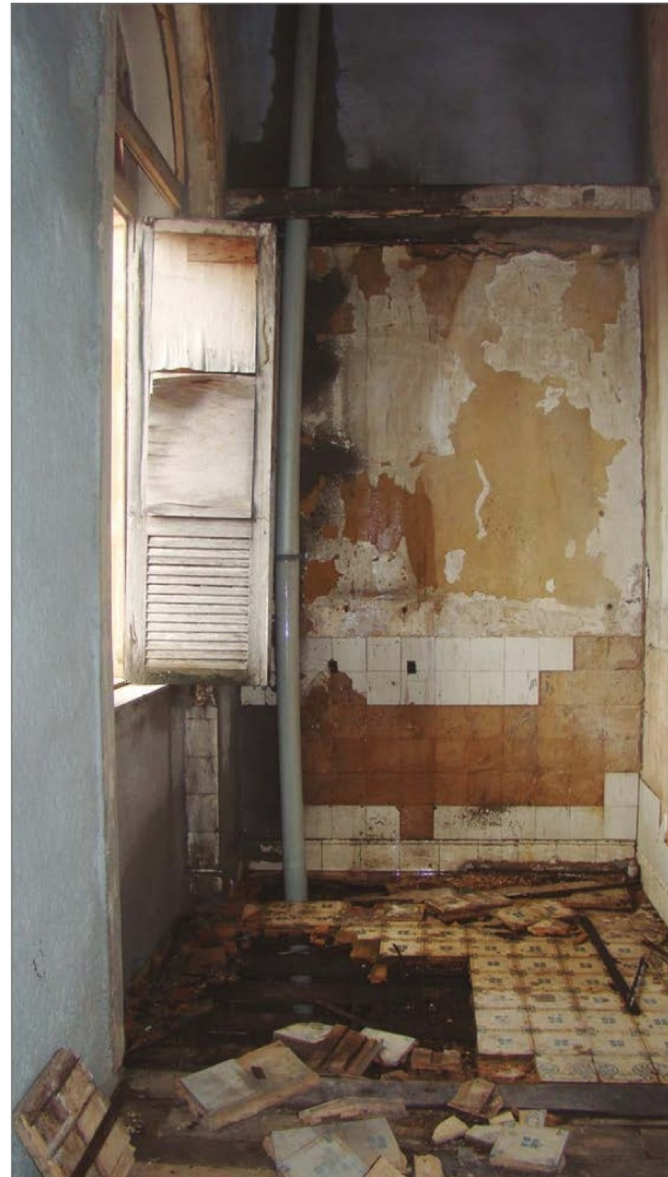
Único banheiro do pavimento superior. Em 2012, apresentava muitos danos estruturais e nos materiais causados pela entrada de águas pluviais, tanto pelo telhado como pela janela. (AS)
