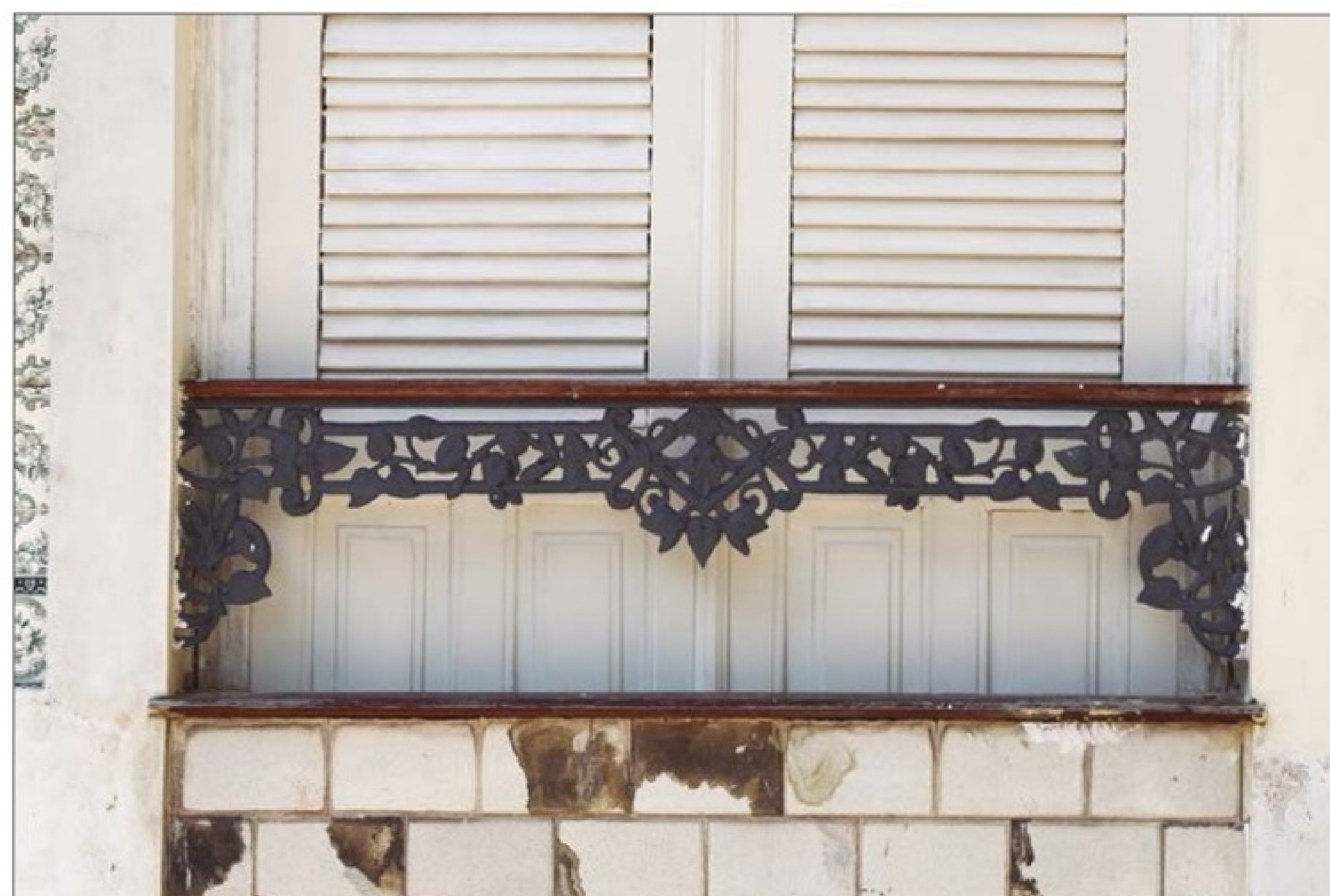
Gradil de ferro fundido original, presente no bloco principal da edificação. (OC)
