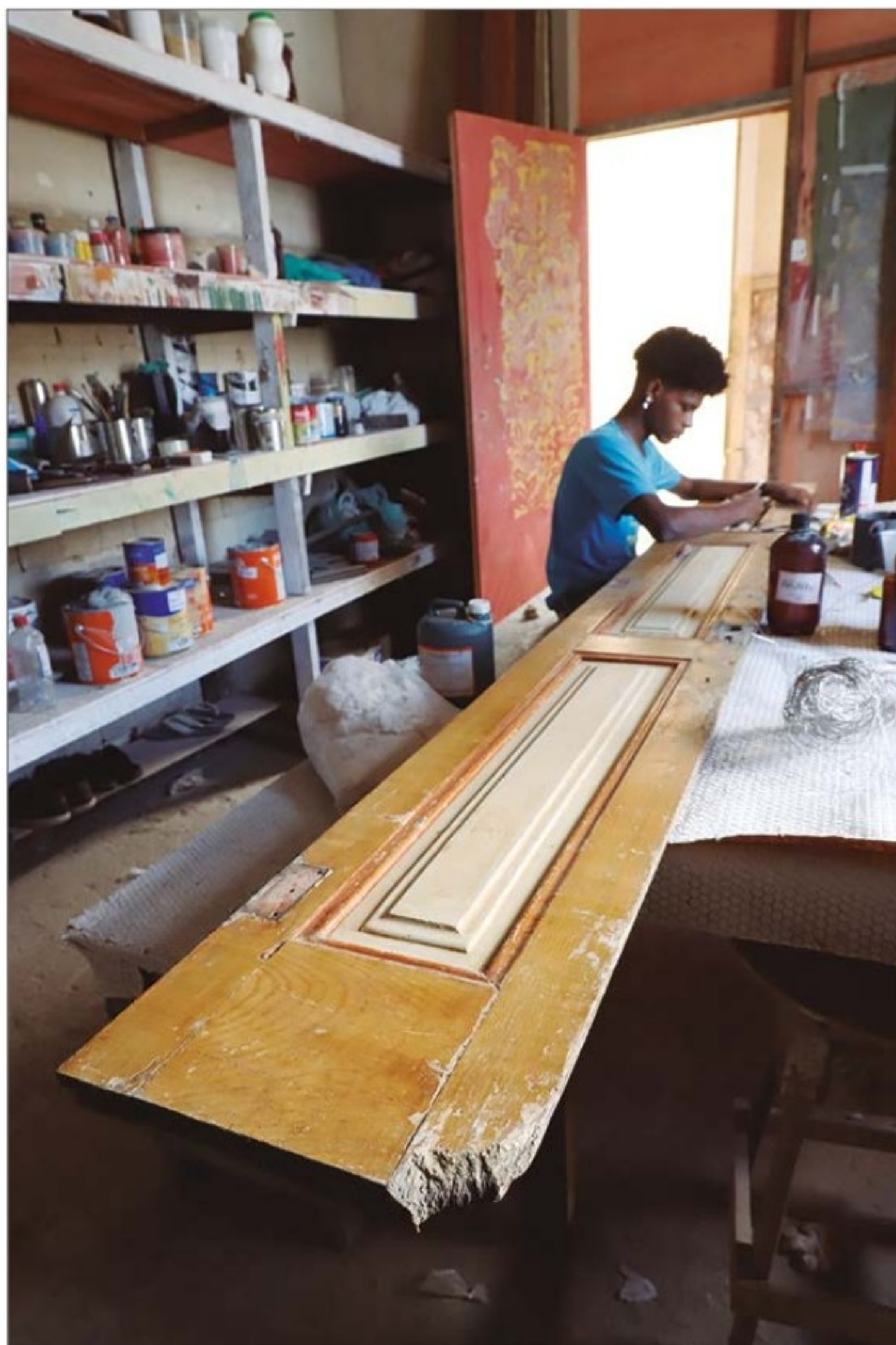
Restauração de pinturas também nas esquadrias internas da área social do pavimento térreo. (OC)
