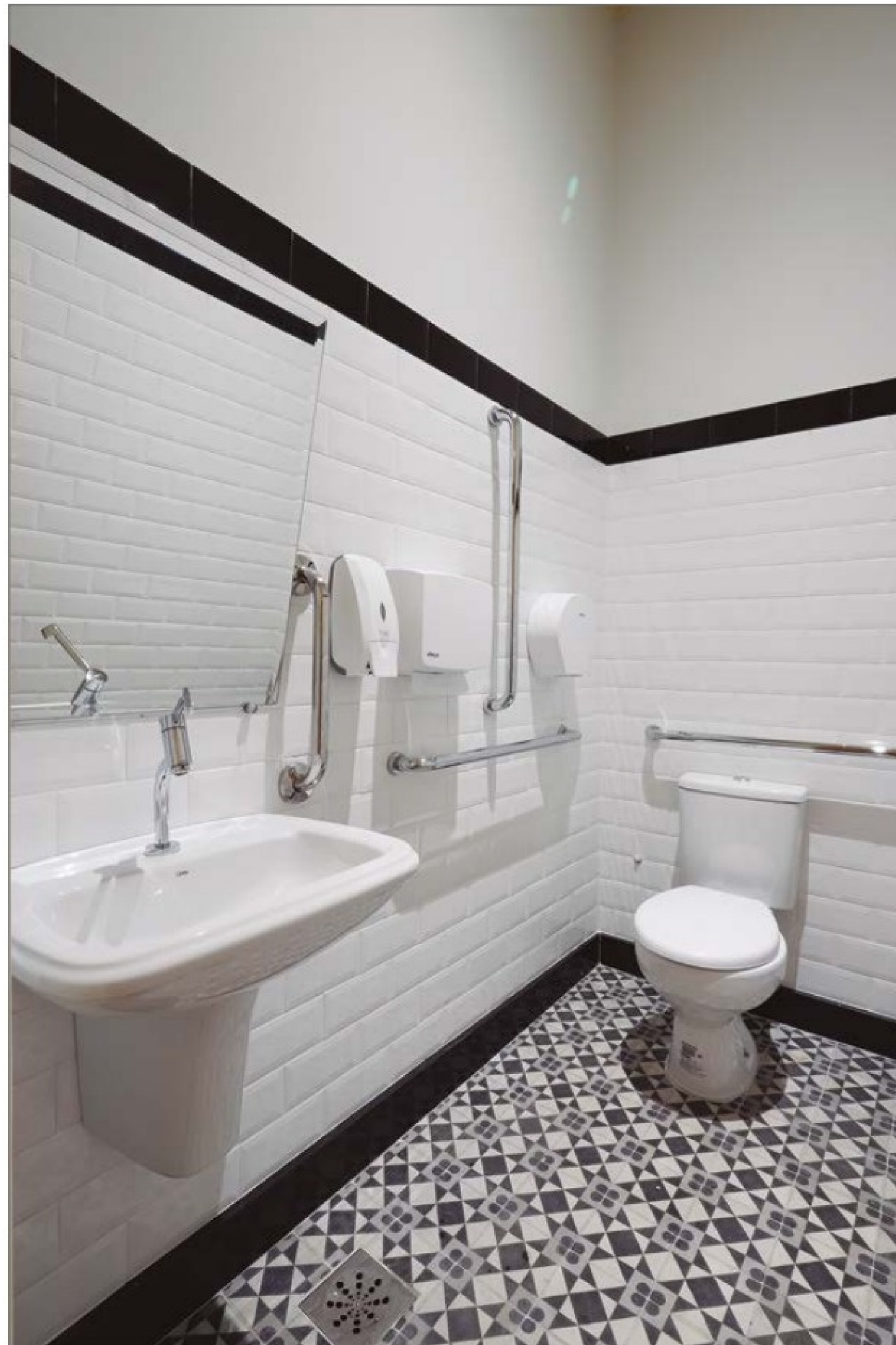
Banheiro para pessoas com deficiência (PcD) implantado no local para melhorar a acessibilidade do prédio. (OC)
