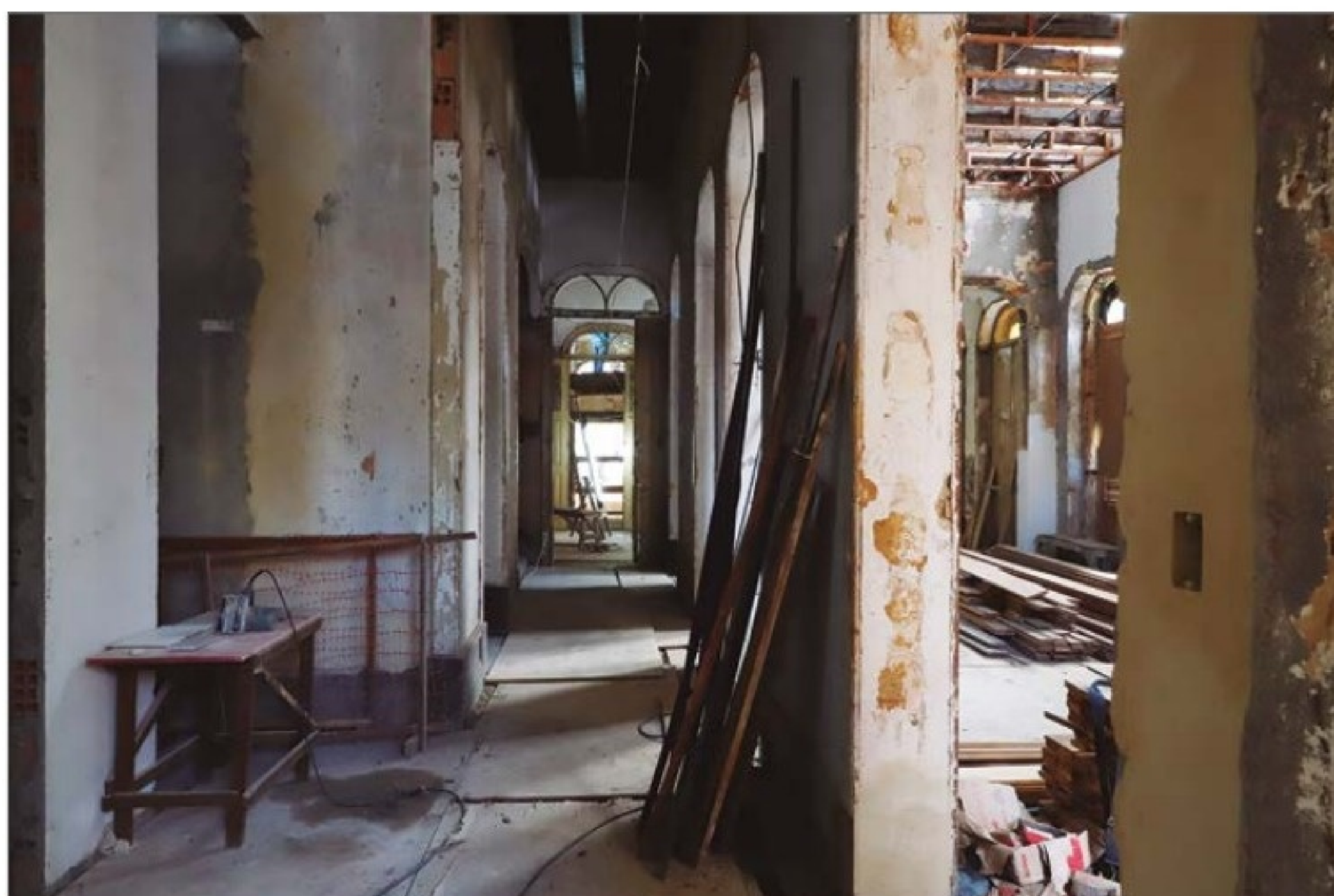
Inspeção das peças de madeira do Palacete, que provocou a retirada de diversas peças originais: dos pisos, dos forros e das esquadrias. (OC)
