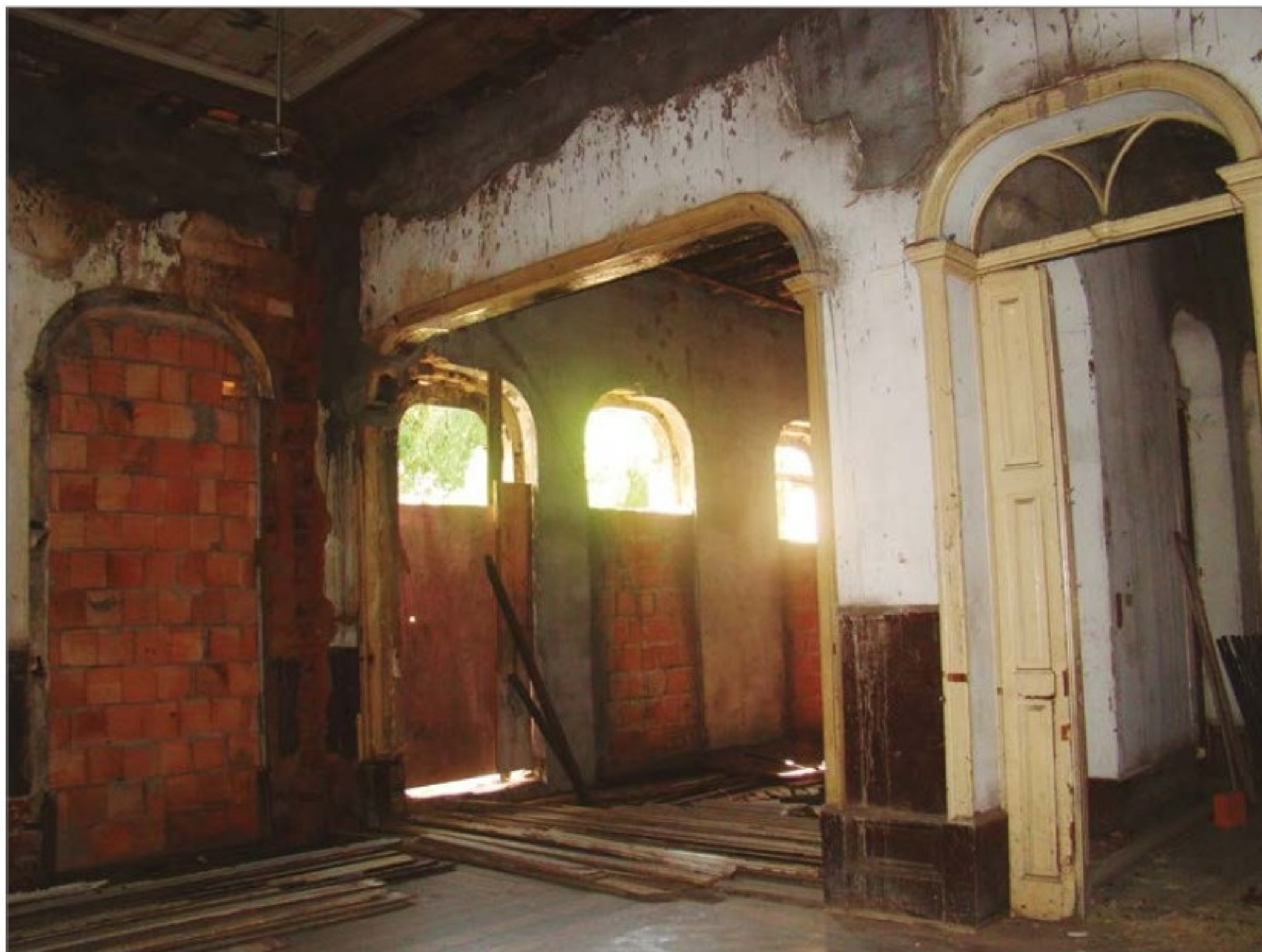
Paredes e vãos do Salão Principal em péssimo estado de conservação, 2008. (AS)
