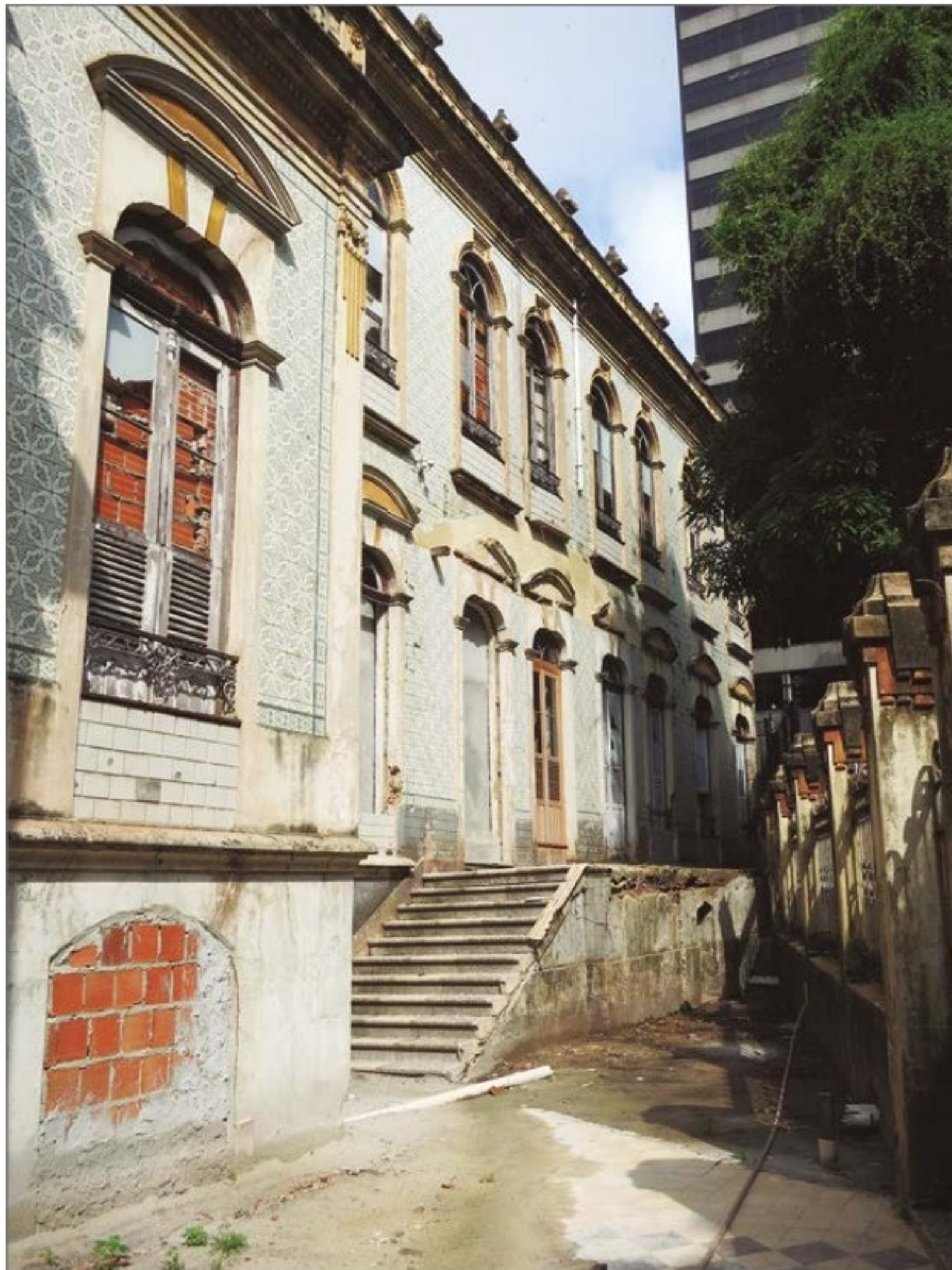
Situação da varanda lateral em 2016: sem a cobertura, sem os gradis e com o piso cedendo. (KM)
