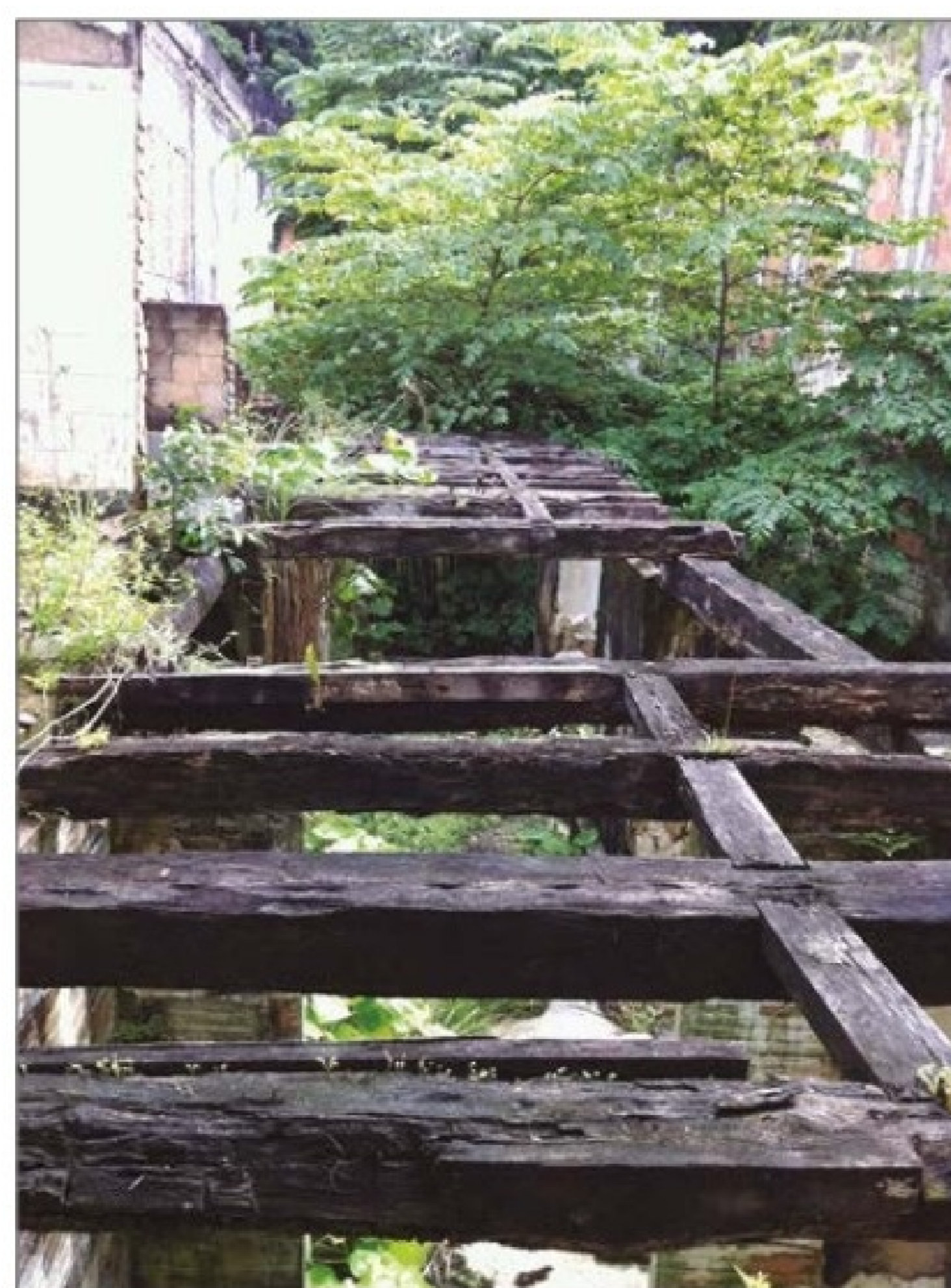
Na Casa 03, a estrutura interna (pisos, paredes e forro) não foi preservada, restando em 2012 apenas alguns detalhes, como os barrotes de madeira do piso e os revestimentos do anexo posterior. (KM)
